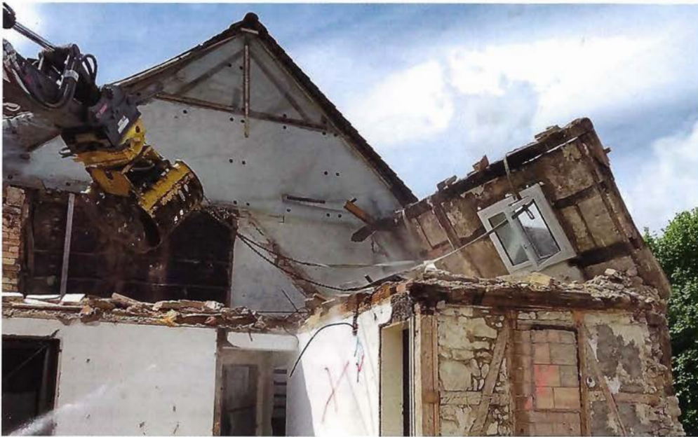
11: Im Mai 2021 wird das Fachwerk von 1472/73 abgebrochen. Hinter der Baggerschaufel ist die Rückseite der Stubenbohlenwand von 1466/67 zu sehen.
