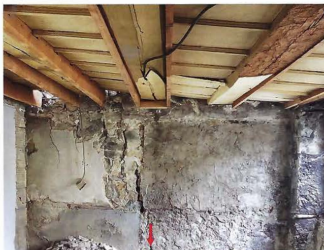
10: Der Anbau von 1690 hat sich im Bereich des Grabens gesenkt, was sich in der schrägen Decke zeigt. Die Risse in der Nordmauer (Pfeil) markieren den Verlauf der älteren Umfassungsmauer.
