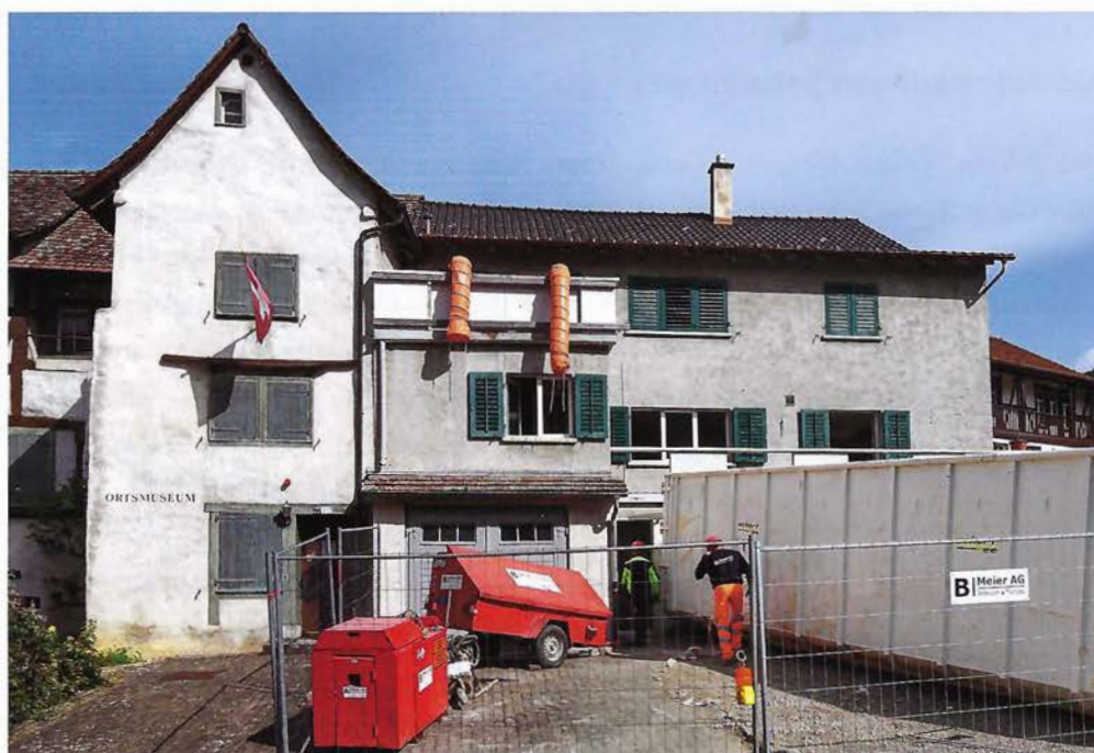
2: Die Abbruchliegenschaft Steig 5 neben dem Ortsmuseum Beringen von der Strasse aus gesehen.
